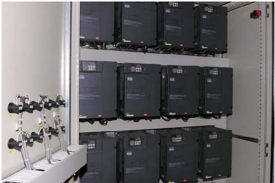
In einen Schaltschrank montierte Frequenzumrichter
