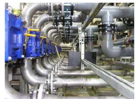
Drehkolbenpumpen zur Sickerwasserbehandlung mit FR-F700
