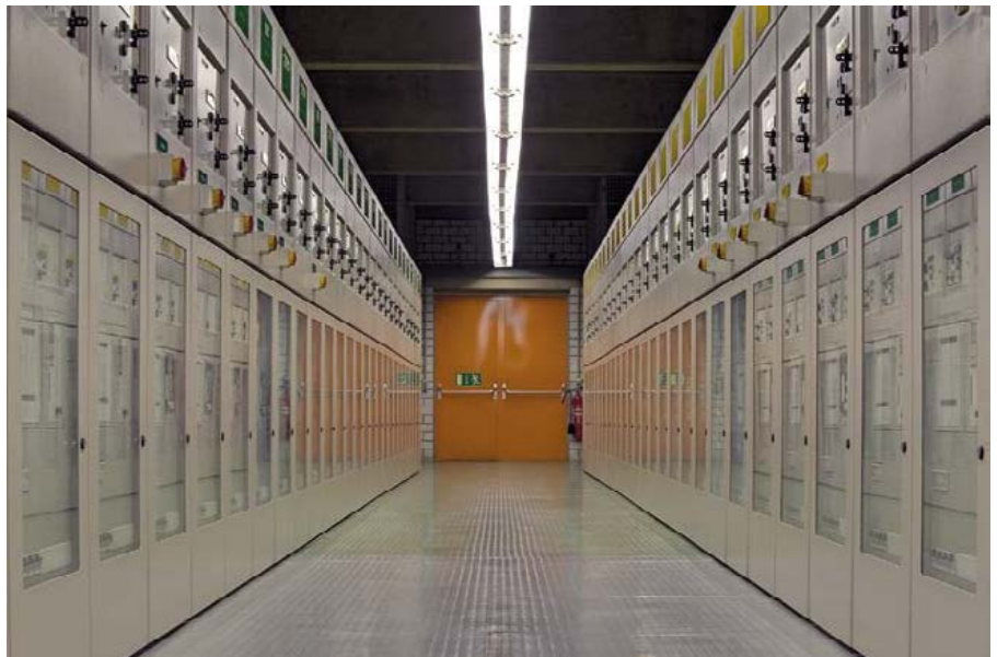
Schalt- und Leitwarte in Tampere mit zahlreichen verbauten FR-F700
